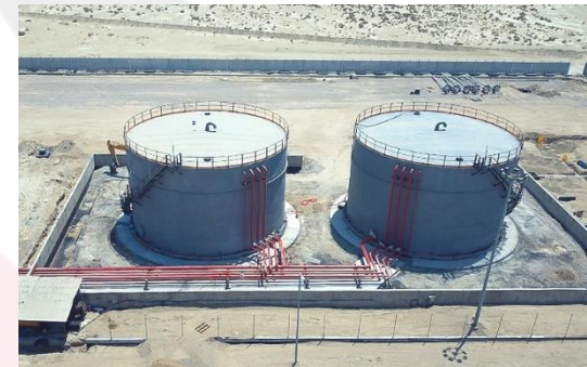
همکاری در تولید و بومی‌سازی ورق‌های (A516Gr.70 Nace , A283Gr.C Nace) سرویس ترش) و ۶,۰۰۰ تن ورق API 5L X60 Nace و API 5L Gr.B Nace پروژه مخازن ذخیره‌سازی گوره-جاسک
